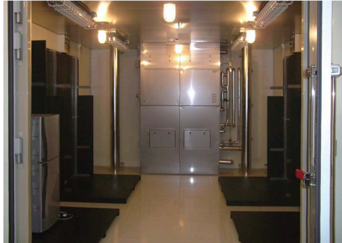
設置場所: インターテックジャパン株式会社鹿島試験所様 冷蔵庫試験室 (保有者: 基準認証イノベーション技術研究組合様)
