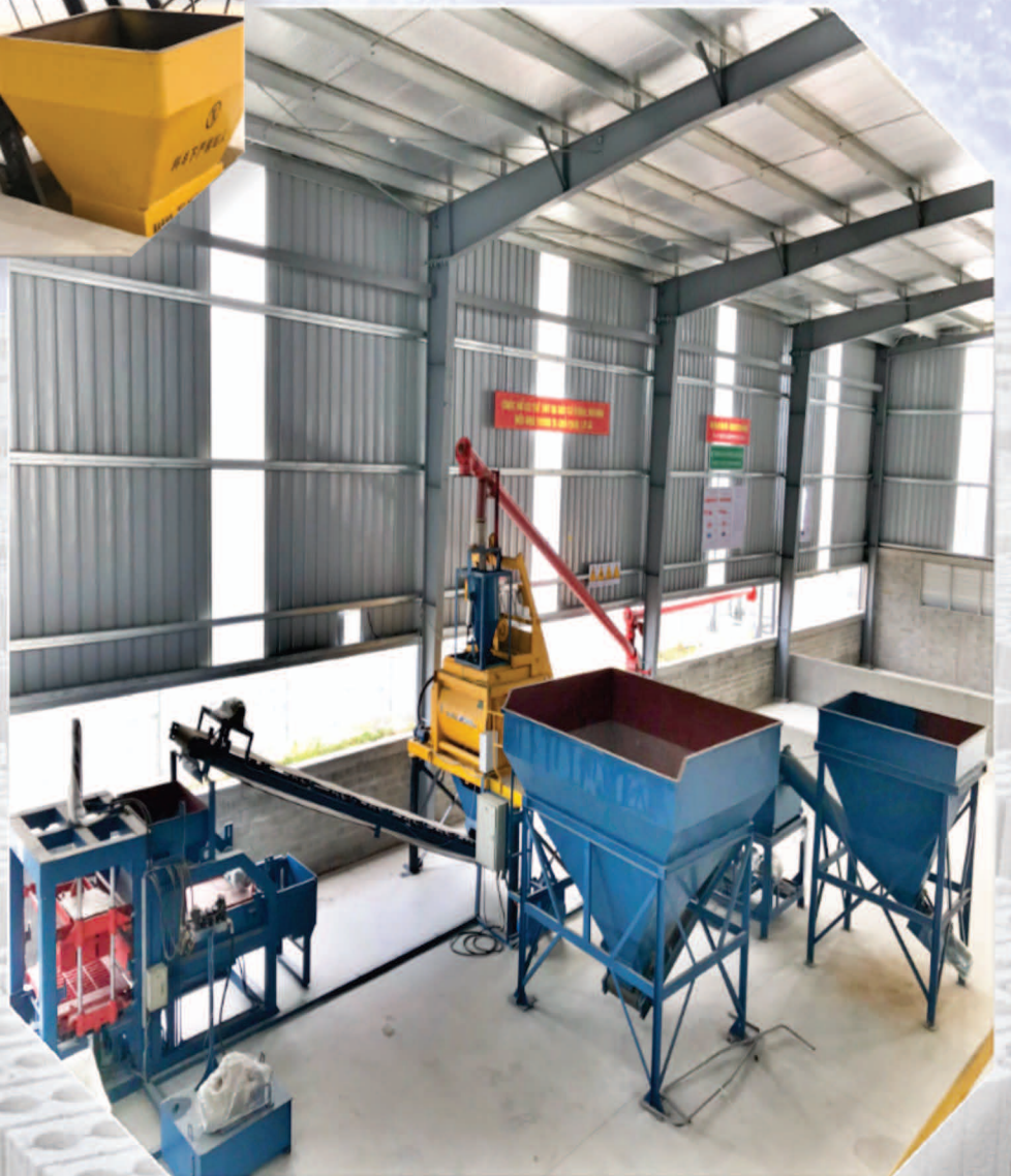
HỆ THỐNG ỔN ĐỊNH, HÓA RẮN STABILITY SYSTEM, SOLID CHEMISTRY (CÔNG SUẤT /CAPACITY: 60 TONS/DAY)
